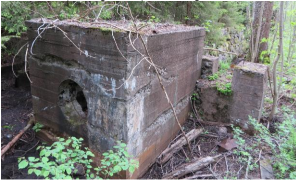
Sumpen med det runda hålet som visar diametern på den 90 meter långa trätub som ledde vatten hit från sjön Förlången, nordväst om kvarnplatsen (Förlångsö 1:21).
