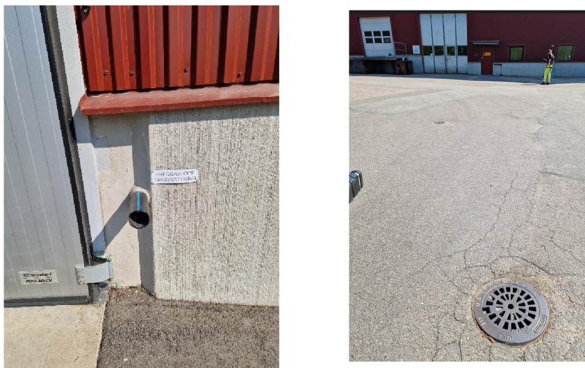
Figur 7: Bräddpunkt för stuprör samt foto av dagvattenbrunn tagna av WSP vid fältbesök 230601.
