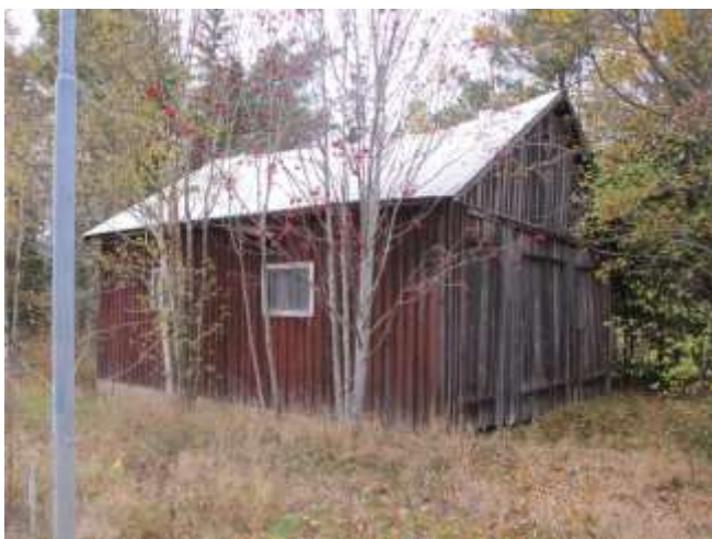
Små bussgarage i trä är inte så vanliga idag. Detta ingår i den väg- och knutpunkt som finns här i Eriksmåla.
