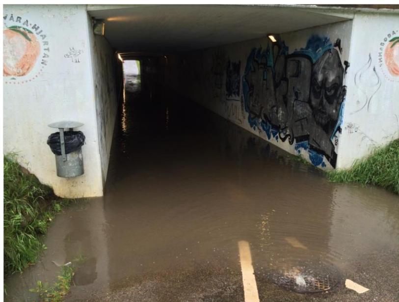
Dagvattenansamling i samband med häftigt regn i Emmaboda
